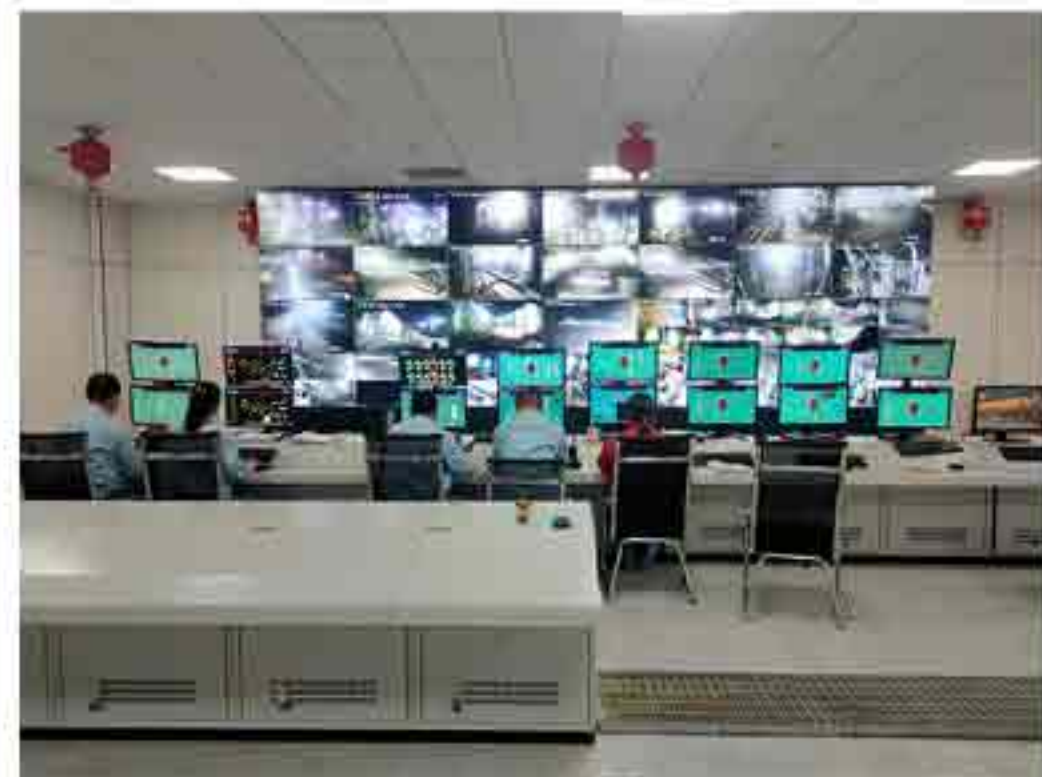
（图为生产运行中心新中控室面貌）
