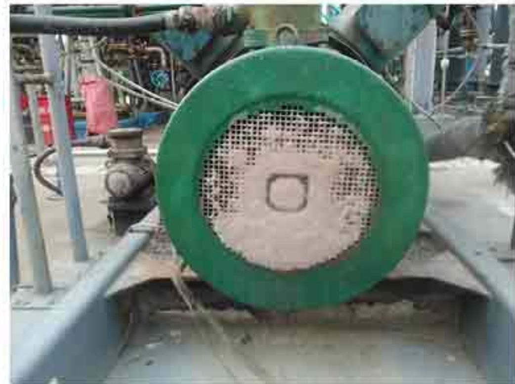
（图为循环氢压缩机机头散热器处积聚的杨柳絮）
